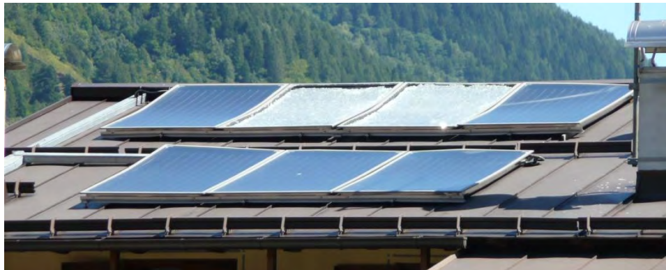
Abbildung 20: Schaden durch hohe Schneelast, Val die Sole, Norditalien (Quelle: Fraunhofer ISE)
