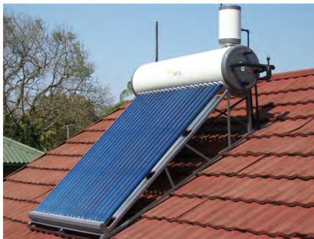
Abbildung 11: Thermosiphonanlage in Schrägdachmontage mit zusätzlichem Anstellwinkel (Quelle: http://flow-tech.co.za )
