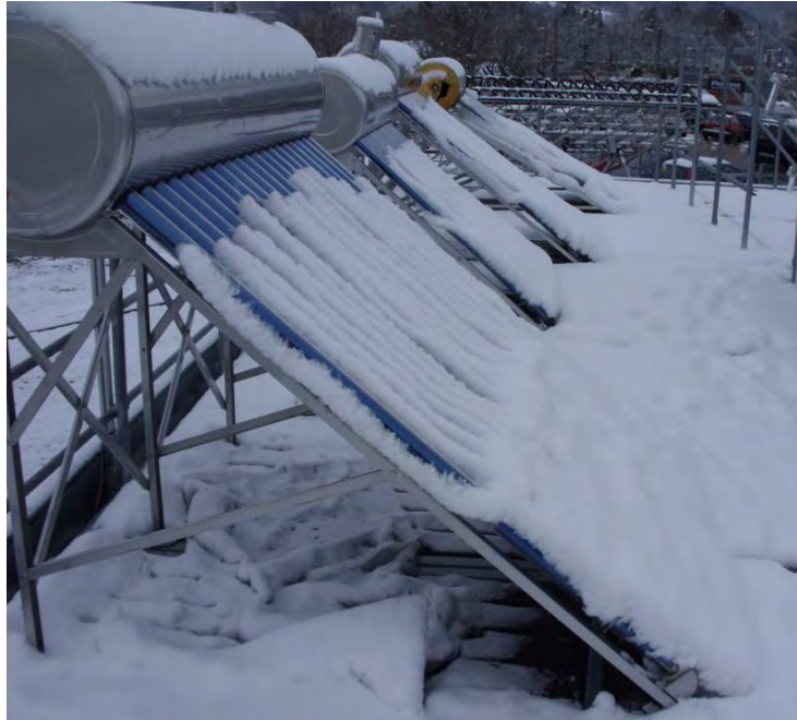
Abbildung 45: Schneeanlagerung an Systemen
