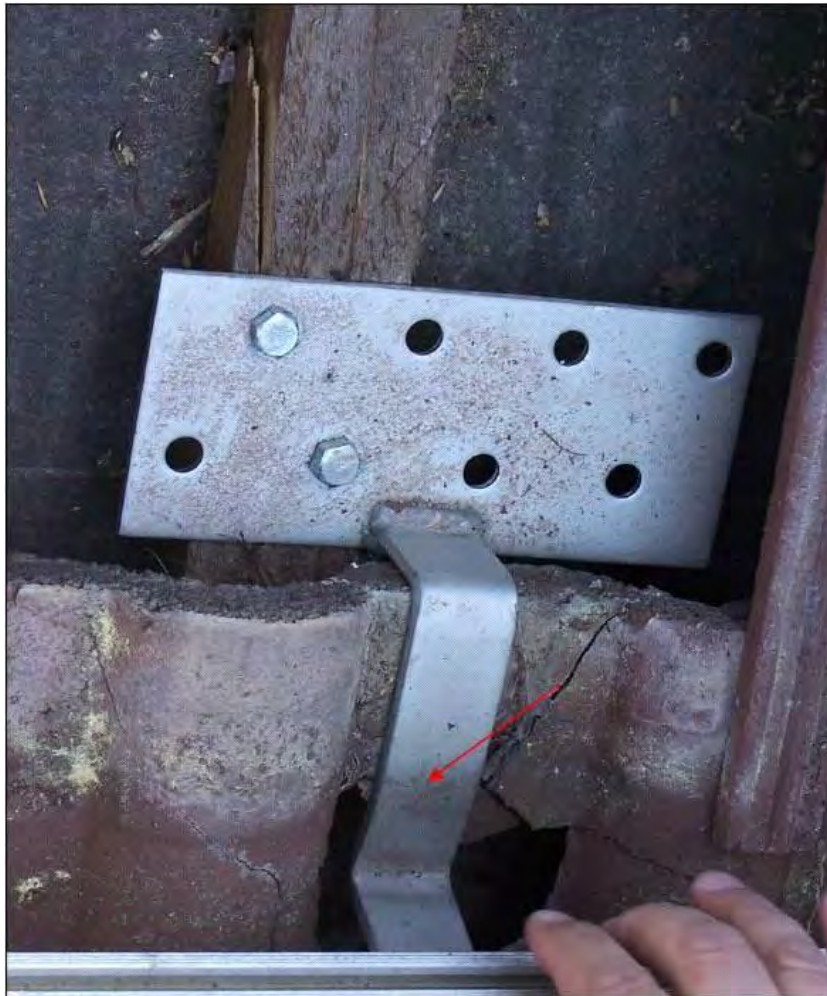
Abbildung 18: Ziegelbruch mit unzulässig installiertem und verformtem Dachhaken (Quelle: Sachverständigenbüro Dipl.-Ing. E. Wiesenhütter)
