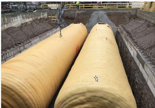
Im Projekt wurden am Fraunhofer ISE ein Kältenetz und ein Kaltwasserspeicher installiert. ©Fraunhofer ISE
