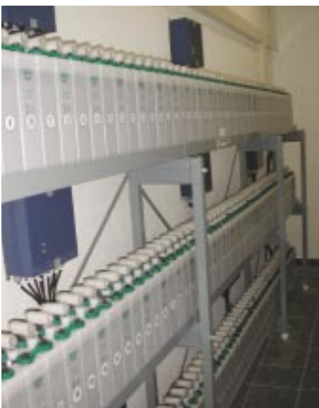
Abb. 3: Notstromversorgung an der Haltestelle Ruit der Stuttgarter Straßenbahn.
